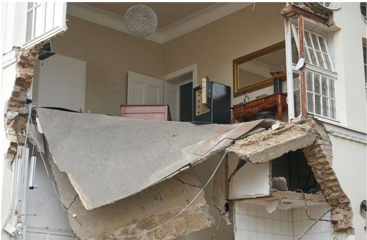
Ein Blick in das zerstörte Kurhaus in Ahrweiler.
